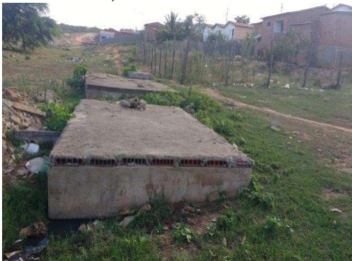
Figura 3: sistema de captação de esgoto (fossas) dentro do riacho, conjunto Novo Horizonte, Cabaceiras – PB,
