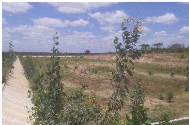
Figura 10: Obra do esgotamento sanitário abandonada.
